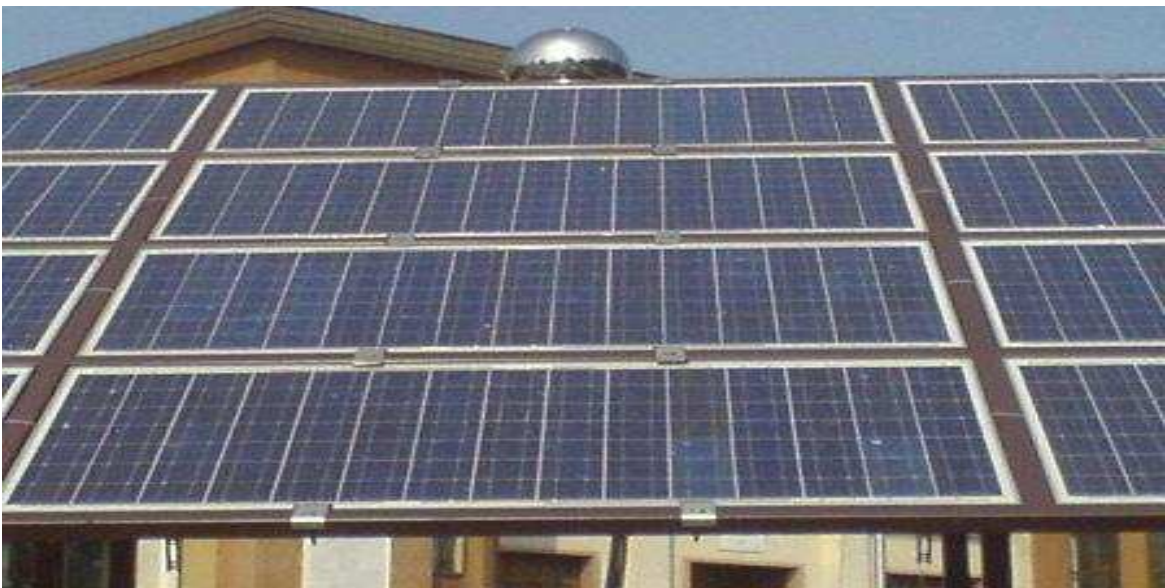
Figura 7.1.1 Sistema sperimentale ad inseguimento solare suntrack
