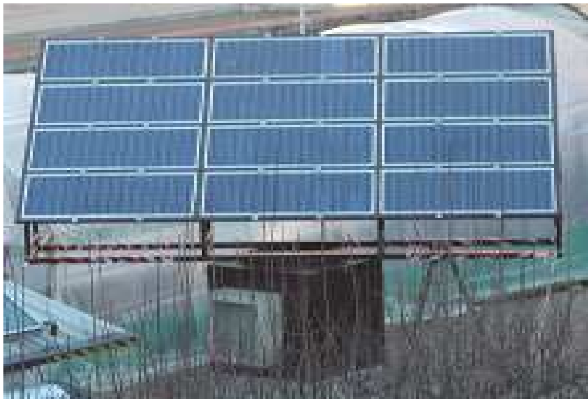
Figura 5.6.5 Sistema sperimentale ad inseguimento solare Suntrack
