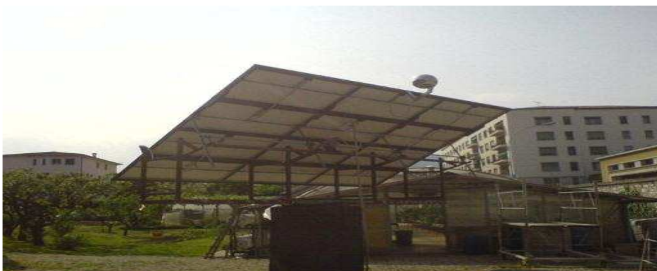
Figura 6.5.7 Sistema sperimentale ad inseguimento solare Suntrack
